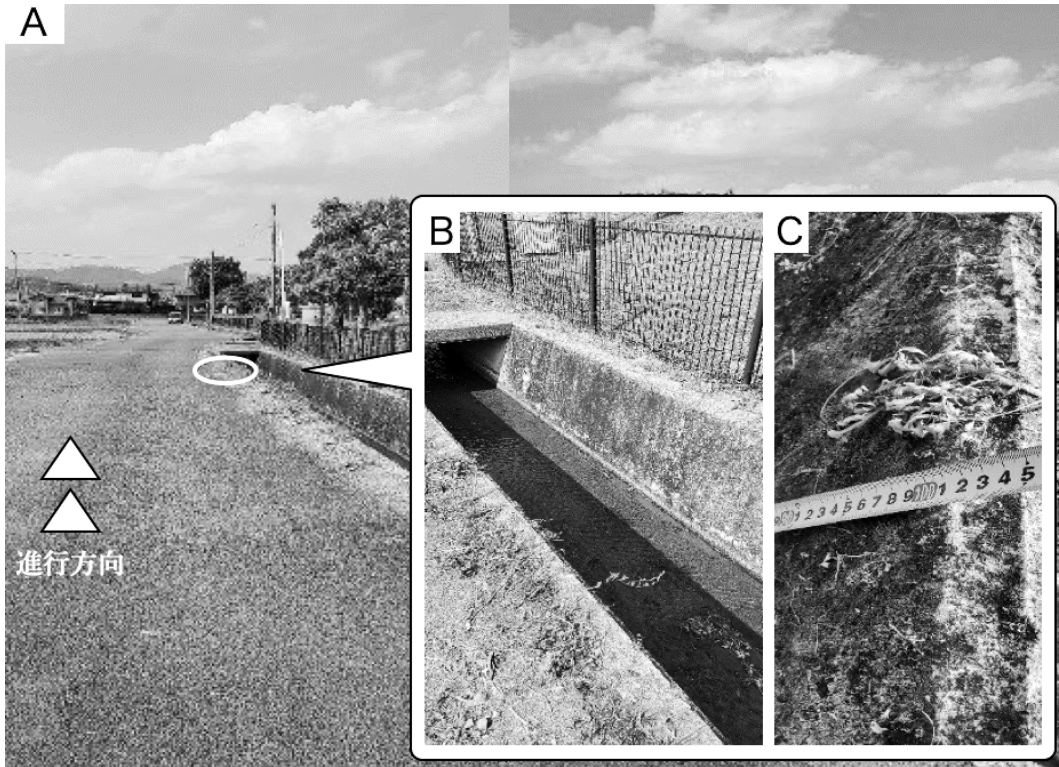
【図2】 A：三角印は進行方向。自転車が右方に傾き転倒し、本児が転落した側溝（丸印） B：受傷した側溝の拡大写真、 C：深さは約 1m 程度であった
